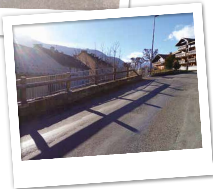
RÉPARATION DE LA BARRIÈRE DE PROTECTION AU-DESSUS DU CINÉMA APRÈS UN ACCROCHAGE ANONYME
